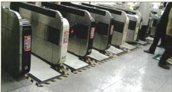
Fig. 7: Tapis microgénérateur au passage des péages
